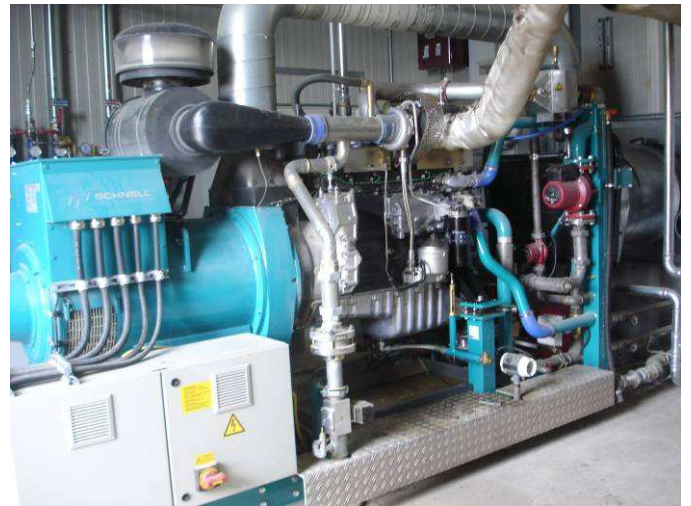
Le groupe électrogène produit l'électricité à partir du biogaz qui est brûlé sans compression.
