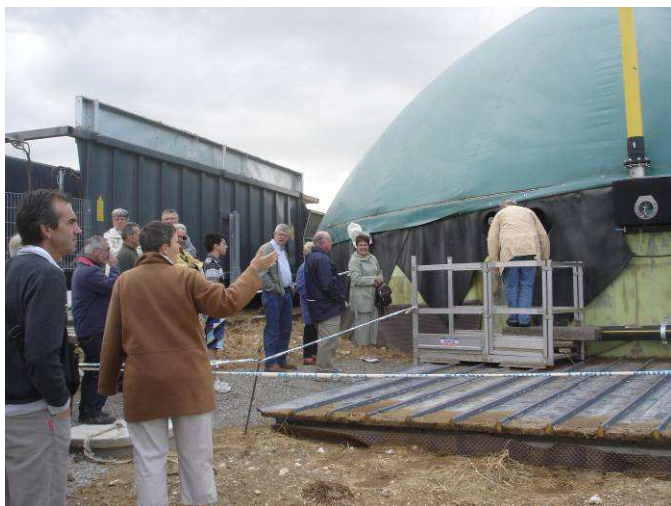
La méthanisation se fait dans un « digesteur » de matières organiques (surmontée d'une bâche en forme de coupole), qui fonctionne comme une panse de vache.
